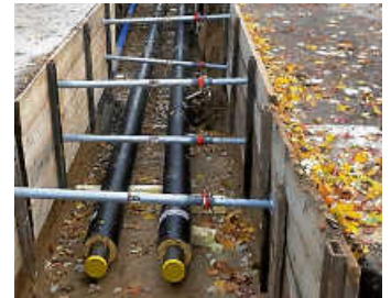
Für eine zukunftsfähige Wärmeversorgung erweitern derzeit viele Kommunen im Landkreis ihr Fernwärmenetz Foto: LEA
