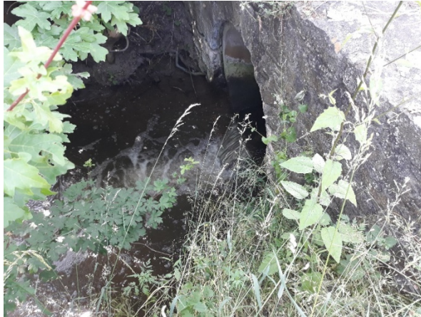
Abbildung 25: Absturz bei einem Durchlass des Mühlbachs zwischen Kirchheim und Bönningheim (Bioplan)
